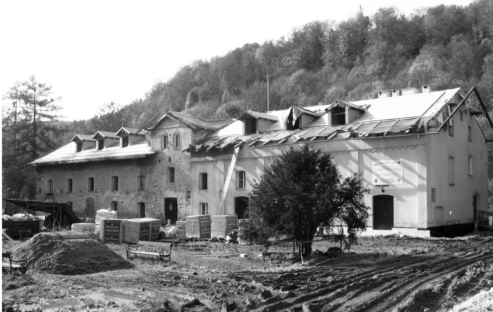
Fot. 4. Prace budowlane w budynku „Hotel Pod Łokietkiem”. Październik 2008 r. Fot. J. Partyka Photo 4. Construction works inside the Hotel Pod Łokietkiem. October 2008. Photo by J. Partyka
