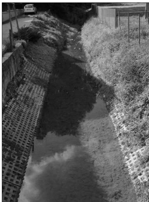
Ryc. 4. Regulacja potoku Prądnik w Sułoszowej I. Źródło przykryte betonowymi płytami. Fot. A. Sołtys-Lelek (2009 r.)
