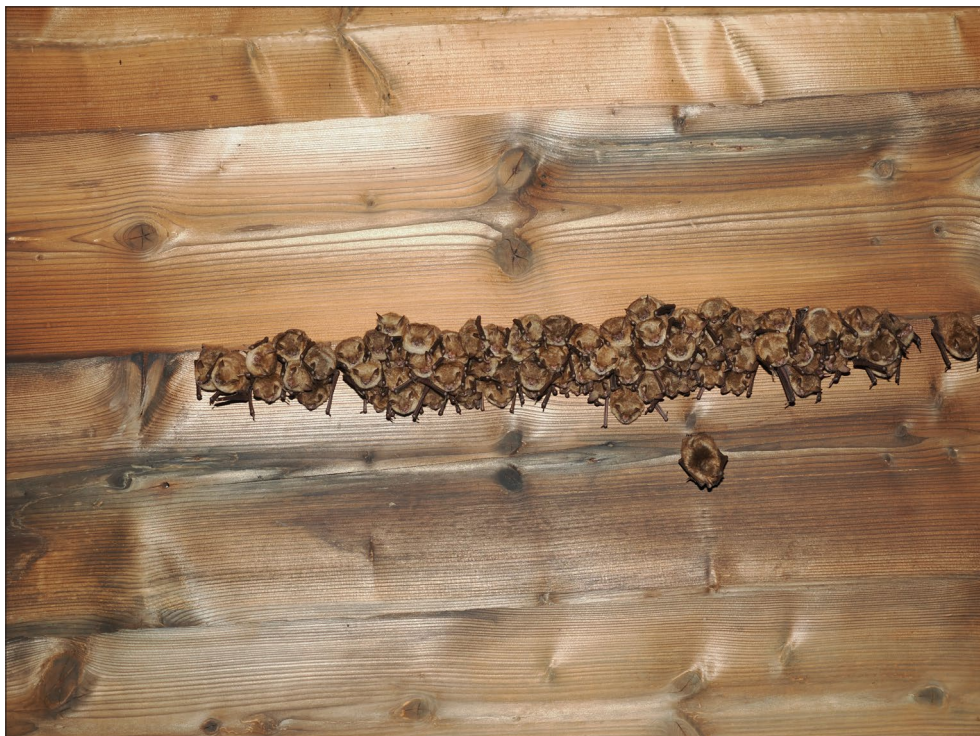
Fot. 2. Nocki orzęsione na strychu kotłowni szpitala uzdrowiskowego. Fot. R. Szkudlarek
