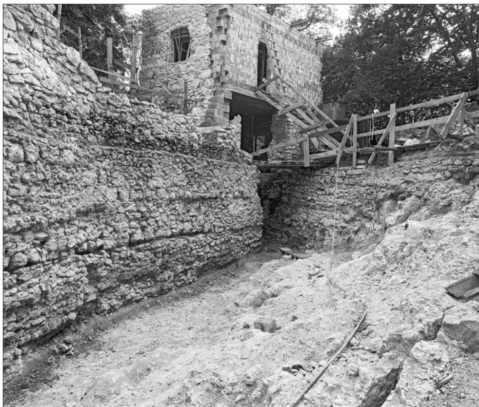
Ryc. 8. Korzkiew – zamek. Fundament południowego odcinka muru obronnego. Widok od północy. Fot. T. Kalarus
