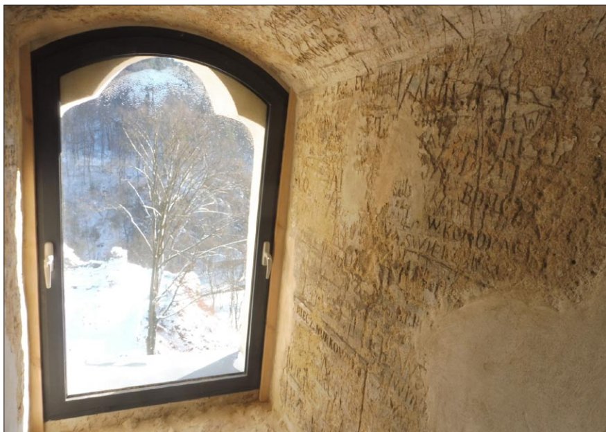
Ryc. 17. Podpisy na tynku w glicie okna I piętra wieży. Fot. M. Bicz-Suknarowska
