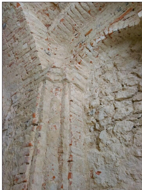
Ryc. 12. Ceglana obudowa wnęki po usunięciu zniszczonych i niewłaściwie położonych tynków z lat 60-tych XX w. Fot. M. Bicz-Suknarowska
